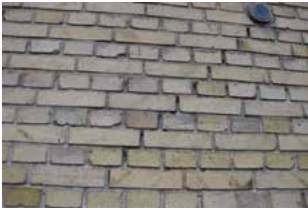
Skrå revne i murværket.
