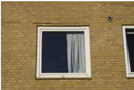
Sydgavl - tegloverligger over vindue er defekt.
