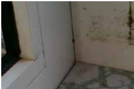
Kondens på vinduer pga. kuldebro og ringe luftskifte.
